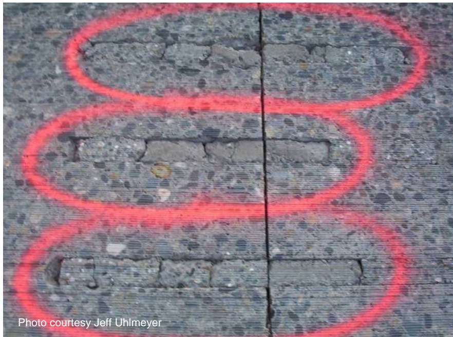
Figure 47 Shrinkage cracks of pour back material.
